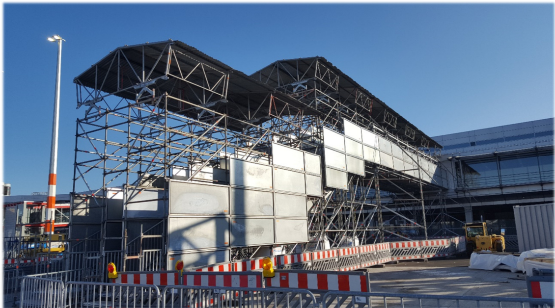
Gerhard Busch Gerüstbau GmbH: Temporäre Fluggastbrücke, Flughafen Hamburg
